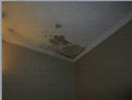
Figura 13 – Avaria teto sala de estar
