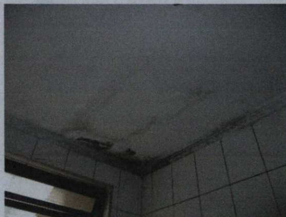
Figura 19 – Umidade – Teto banheiro
