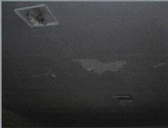
Figura 9 – Avaria teto da cozinha
